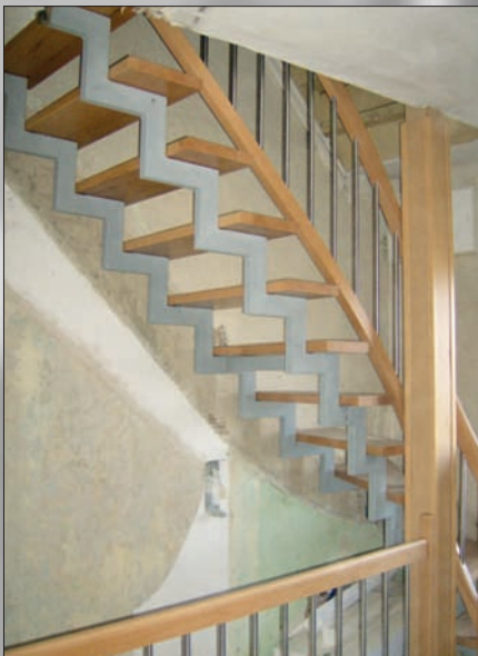
OG-Zweiholmtreppe, offen mit Holzgeländer und Edelstahlstäben
