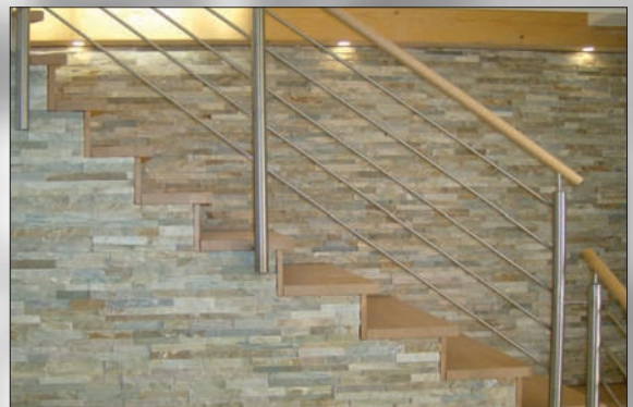
Zweiholmtreppe geschlossen zum Keller mit Naturstein, Relinggeländer aus Edelstahl
